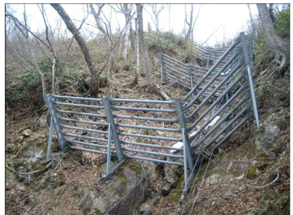
図17 凹凸斜面に設置された吊柵
